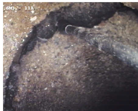
Brud på kloakrør
